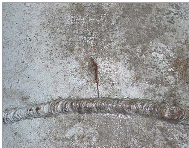
Рис. 3. Стресс-коррозионная трещина в околошовной зоне, ориентированная поперек оси стыкового кольцевого шва
