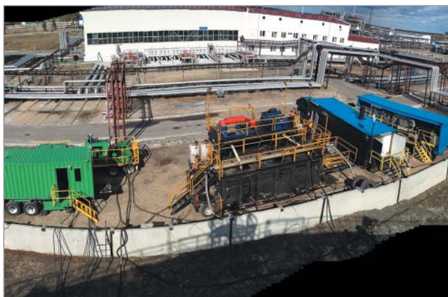
Рис. 12. Общий вид системы очистки резервуаров в Западной Сибири, 2013 год. PVC-20.000 м 3
